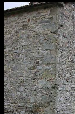
Buon ammorsamento tra muri maestri ortogonali ed il paramento interno.
