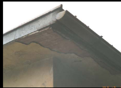
Gronda danneggiata e pericolante.
