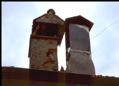
Comignolo mal vincolato alla copertura.
