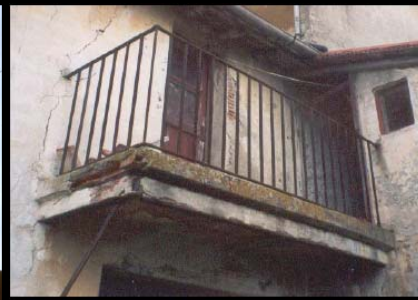
Balcone mal vincolato alla parete verticale.
