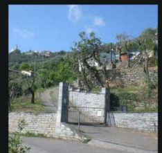
13 - terraces collapsing, S. Giulio (Lavagna)
