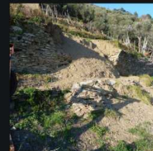
10 - terraces collapsing, Soriana (Lavagna)
