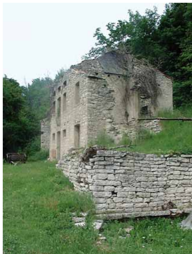
Ambito a) Edificio rurale in stato di abbandono lungo l'antica "Via Maestra" a Revine Lago
