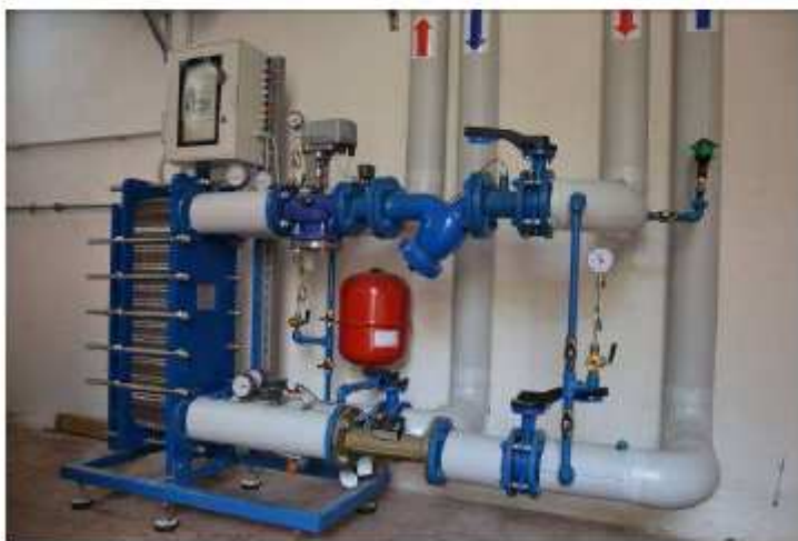
Fig. 7 - STC 1 Sottostazione Scuola Media ed Elementare
