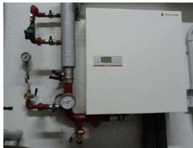
Fig. 8 - STC 2 Sottostazione Pro Loco
