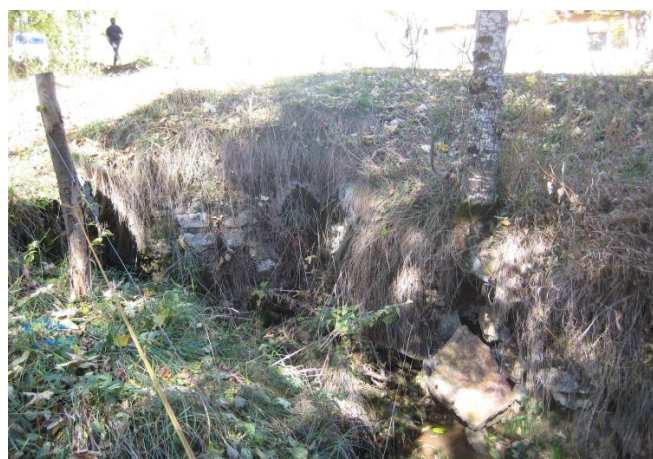
Velo veronese – Loc. Mulbese, Valle non demaniale –cedimento e sottoescavazione delle difese spondali che minacciano la stabilità della strada provinciale.
