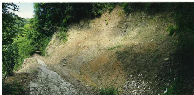
Stato di fatto a seguito evento franoso
