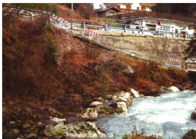
Tratto spondale in erosione sul T. Pettorina in comune di Rocca Pietore.
