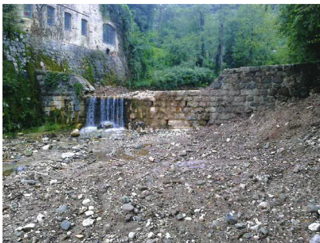
Briglia di cui è prevista la sostituzione
