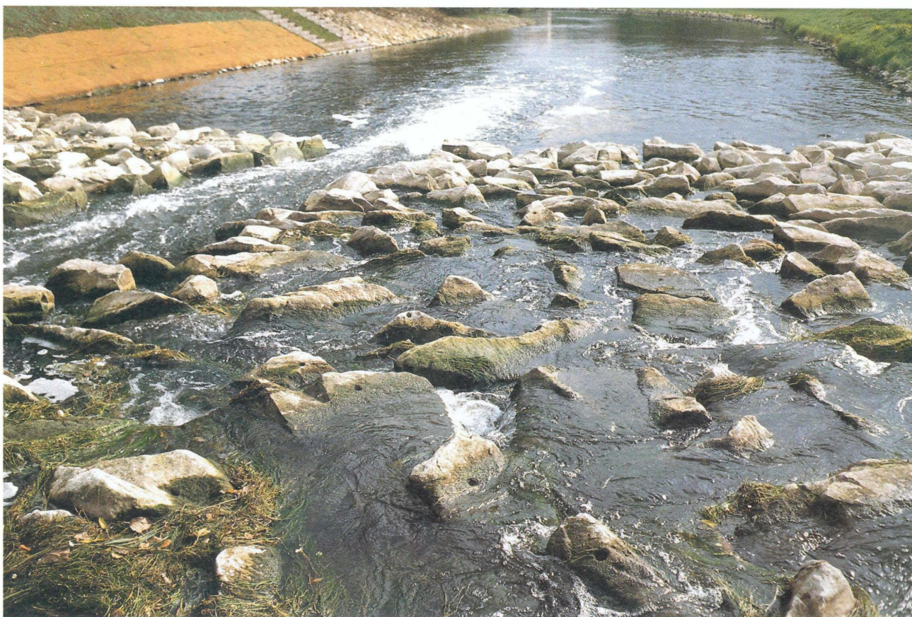
TAV. N. 44 Rampa in pietrame (la presenza di zone a corrente rapida e a corrente lenta favorisce la risalita della fauna ittica) (Fiume Danubio) Tipologia n. 26 a5
