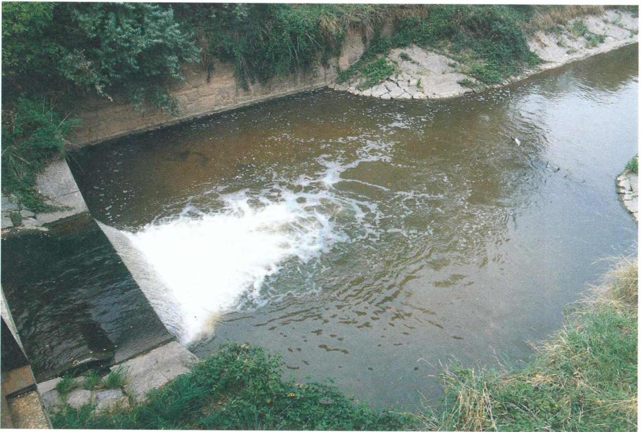
TAV. N. 39 Briglia in calcestruzzo (situazione prima della realizzazione della rampa in pietrame) (Fiume Pfrimm) Tipologia n. 26 a10
