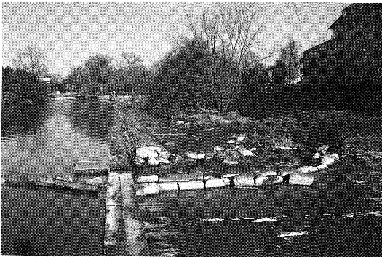
Foto n. 7 - Rampa in pietrame (passaggio per pesci inserito in un'opera trasversale - durante una portata di magra) (Fiume Nagold) Tipologia n. 26 b2
