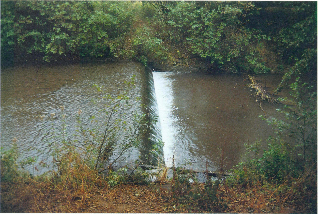
TAV. N. 33 Soglia in calcestruzzo (prima della realizzazione della rampa in pietrame) (Fiume Odenwälder Elz) Tipologia n. 26 a8
