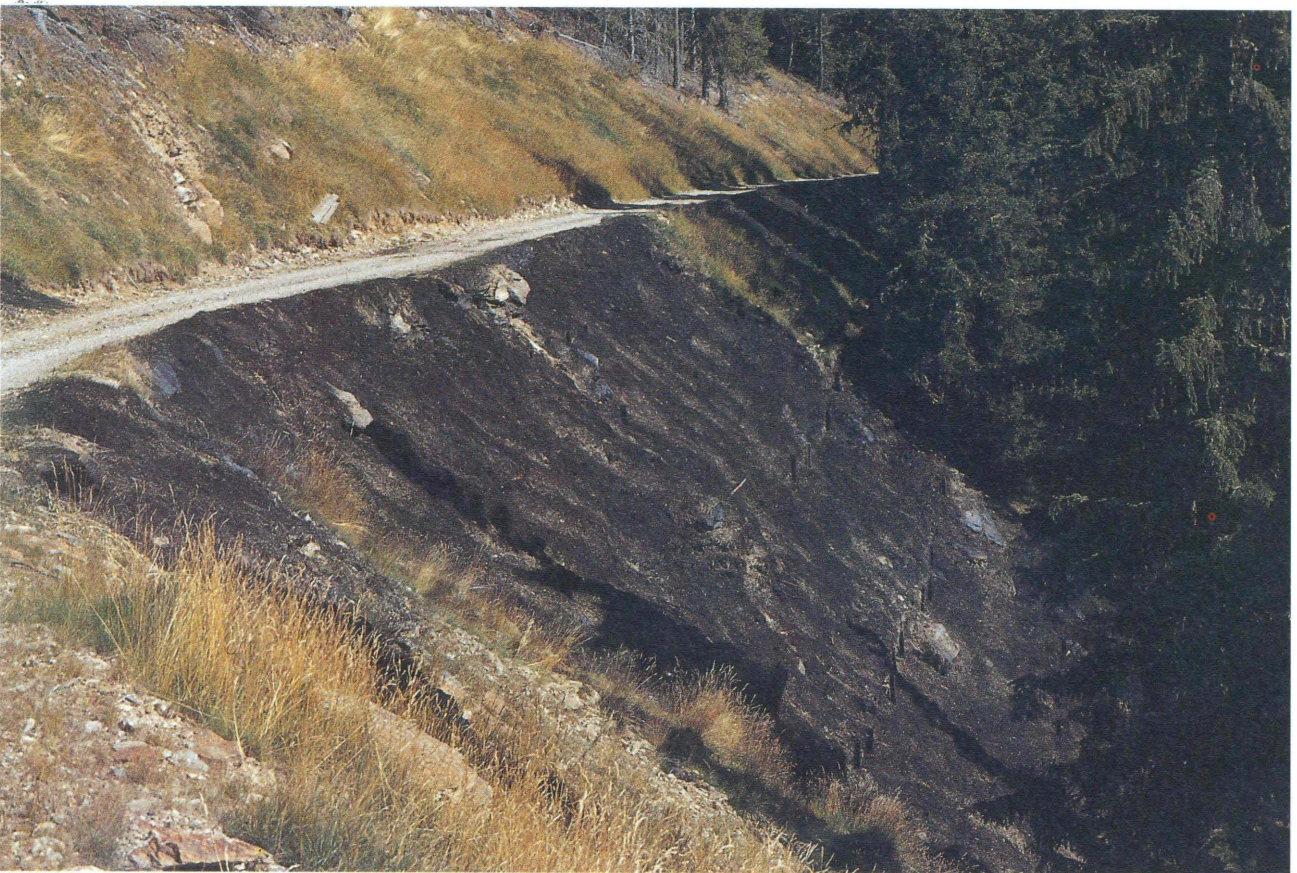
TAV. N. 22 Palizzata in legname ed inerbimento con coltre protettiva di paglia e bitume (fase di realizzazione) (Val d'Ultimo - Bz) Tipologie n. 1 e 13
