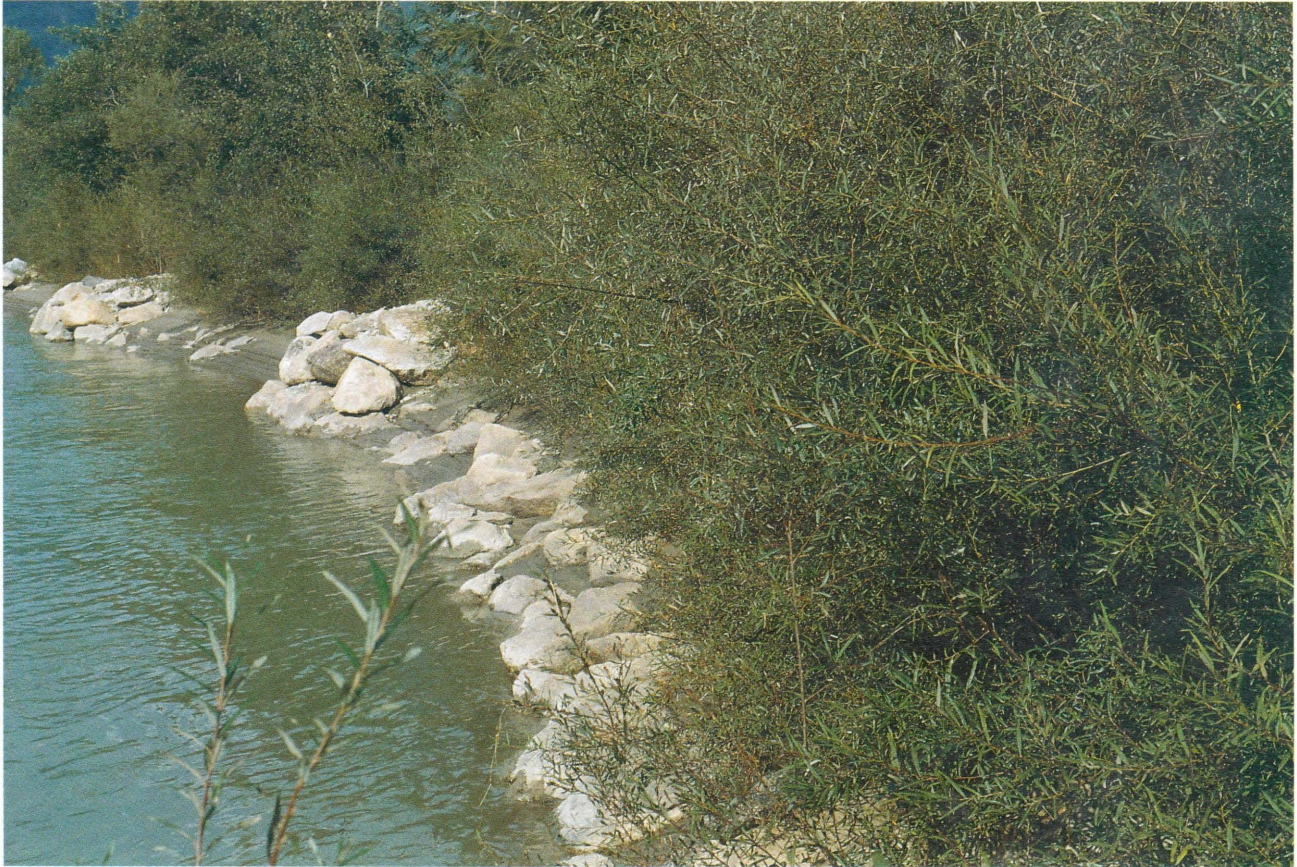
TAV. N. 31 Copertura diffusa con astoni di salice (dopo 3 anni) (Rio Aurino, Val Pusteria - Bz) Tipologia n. 20
