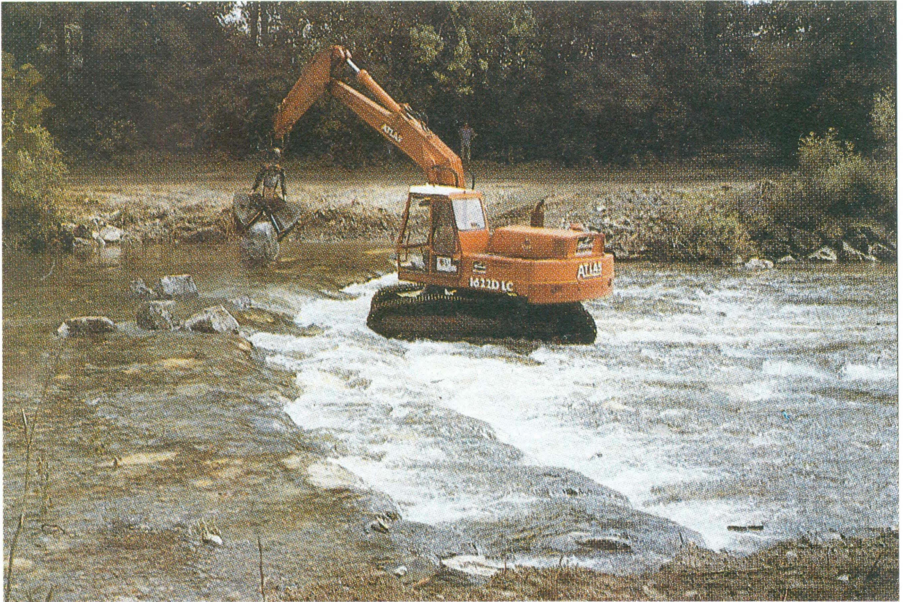
TAV. N. 41 Rampa in pietrame (posa in opera dei massi con mezzo meccanico) (Fiume Argen) Tipologia n. 26 a3
